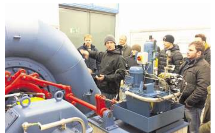
Zum Ausbildungsbereich „Wasserkraft“ stand auch ein Besuch des Wasserkraftwerk am Perlsee auf dem Unterrichtsplan.
